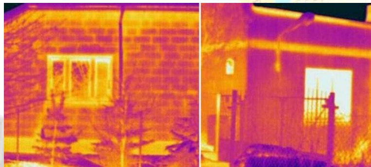
Рис. 3 «Містки» холоду в стіні виявлені тепловізором
